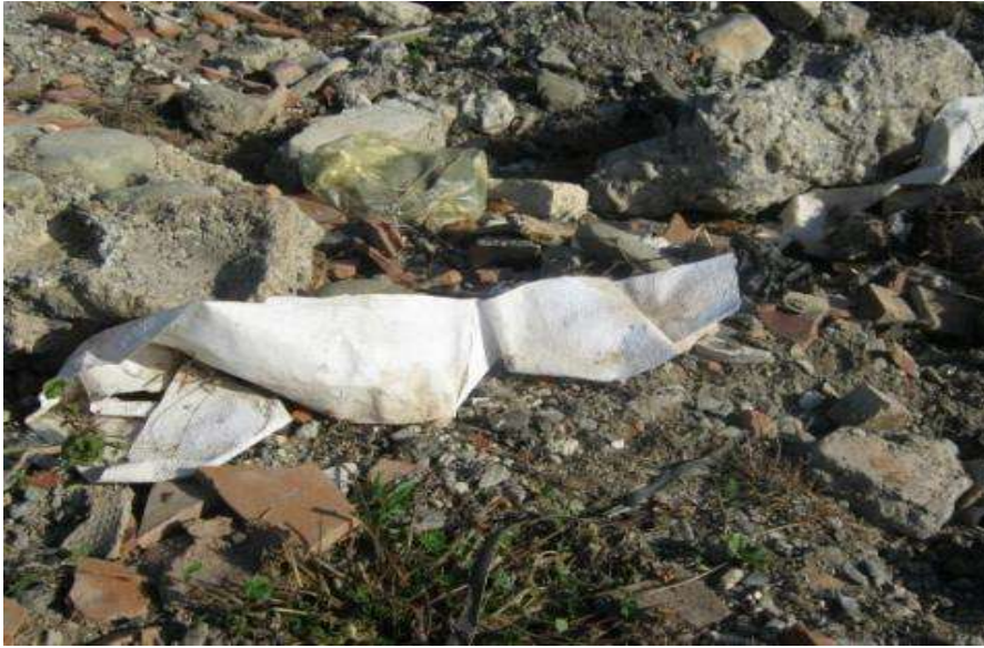
უბანი 12– სახასიათო ნარჩენები: კერამიკული ფილების , აზბესტცემენტის და კედლის ნამტვრევები. წინა პლანზე – თეთრი ფერის ბოჭკოვანი საიზოლაციო მასალა.
