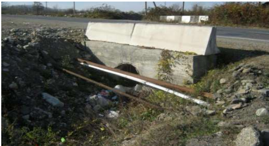
უბანი 1- შუა ნაწილში არსებული წყალსატარი მილის სათავისი; მოჩანს აგრეთვე წყალსადენი მილები 50 და 100 მმ დიამეტრის და ელექტროკაბელი (თეთრი ფერის იზოლაციით).
